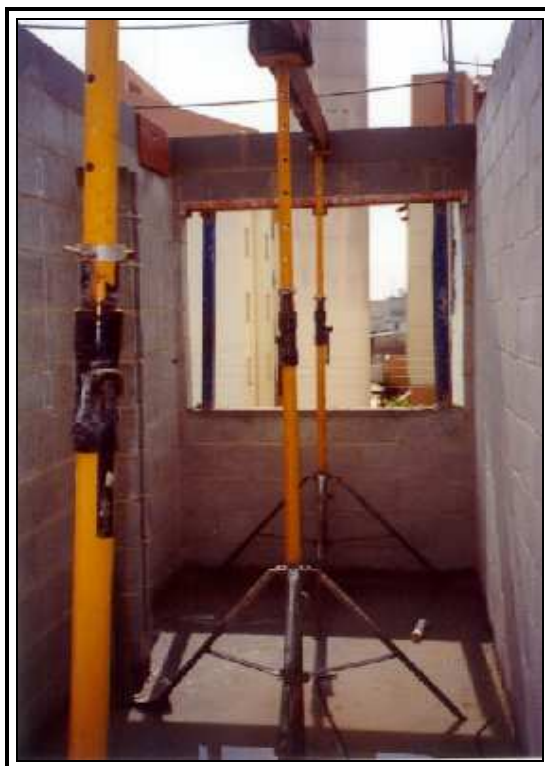
Figura 10: No fundo é possível verificar o vão com o requadro metálico desenvolvido na FORTENGE.
