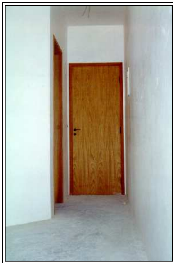
Figura 11: Porta pronta instalada com espuma de poliuretano, serviço executado com a pintura e acabamentos finais já executados
