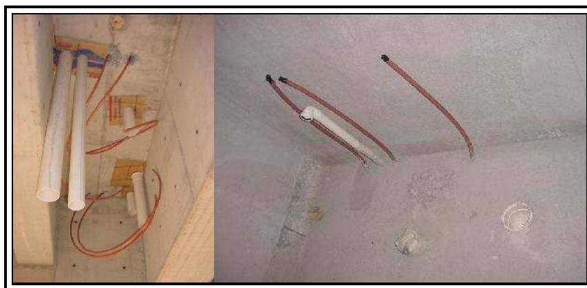
Figura 9: verifica-se o uso de mangueiras de distribuição para os ramais de alimentação de Água quente e fria nos ponto de lavatório e vaso sanitário
